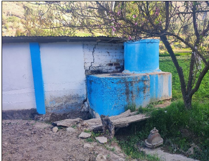
Imagen N° 29: Cámara de reunión de captación Moya I, en peligro de inundación
